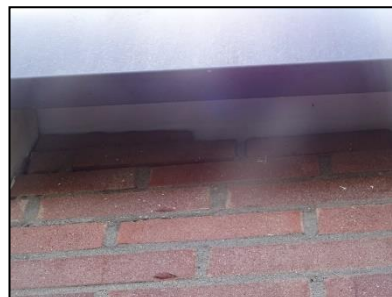
Figuur 16. Openingen bij dakrand in opslaghallen.
