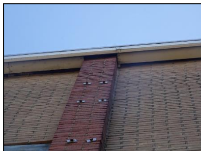
Figuur 14. Opening in dakrand productiehal.
