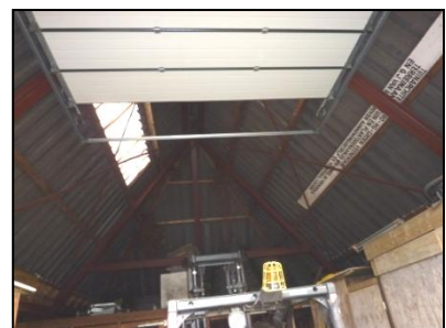
Figuur 14. De opslaggebouwen hebben geen dakbeschot, waardoor ze ongeschikt zijn als verblijfplaats voor vleermuizen.
