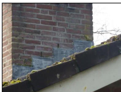
Figuur 13. Schoorsteen met open stootvoegen.
