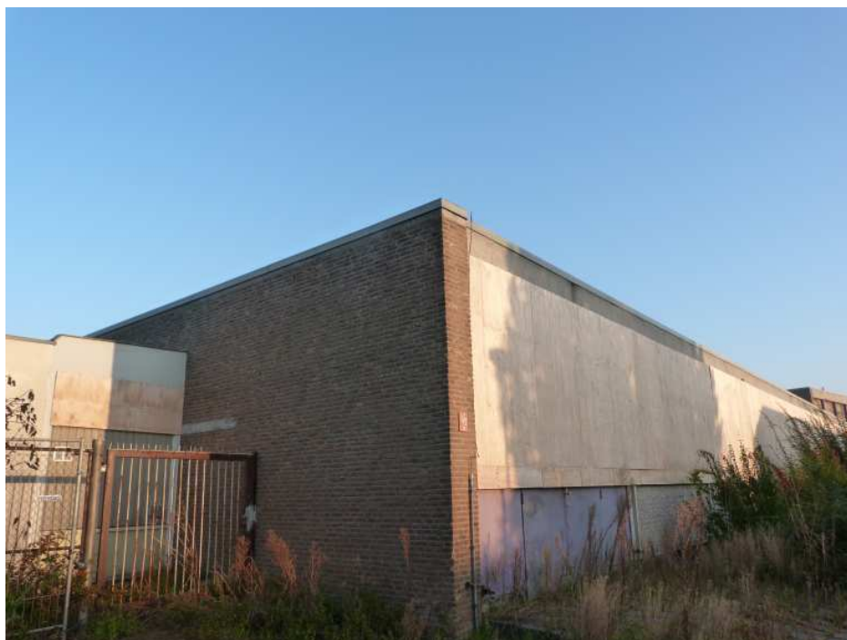
Figuur 2. Plangebied zijde Ambachtsstaat. Onder der metalen strip aan de bovenzijde van de muur bevindt zich de toegang tot een zomerverblijfplaats.
