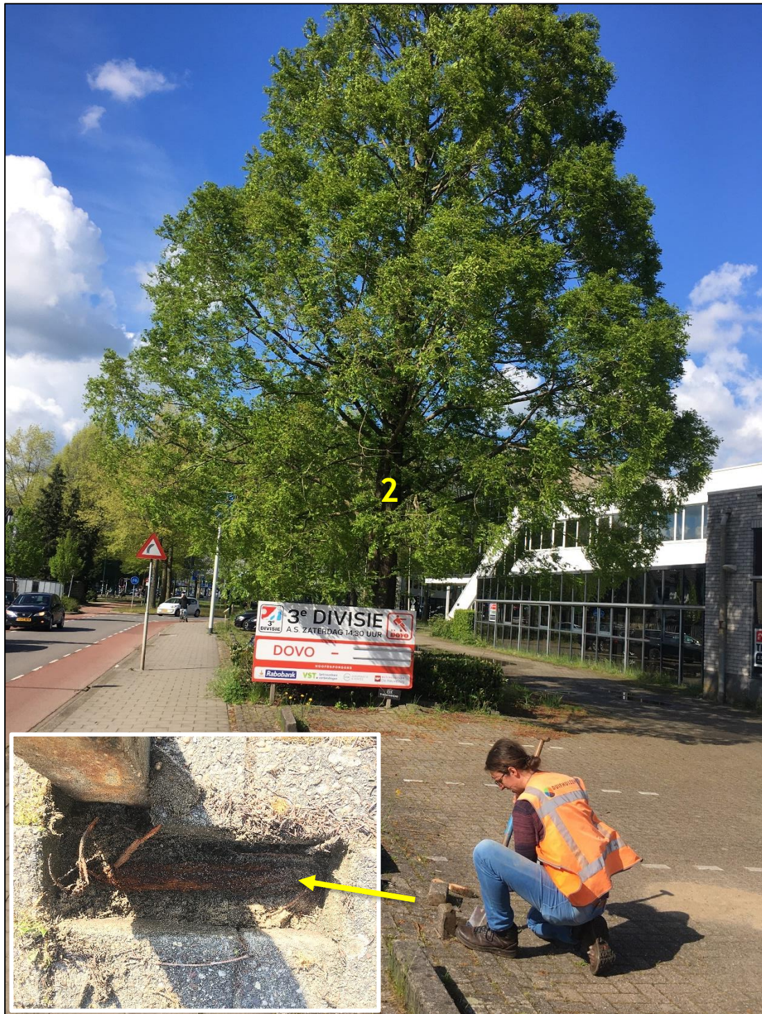
Afbeelding 17: Op 15 meter uit boom 2 is beworteling ( \Phi 5 cm) aanwezig onder de klinkerverharding;
