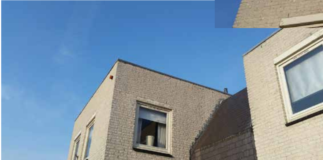
Open stootvoegen in gebouw 1
