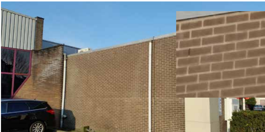
Open stootvoegen in gebouw 4
