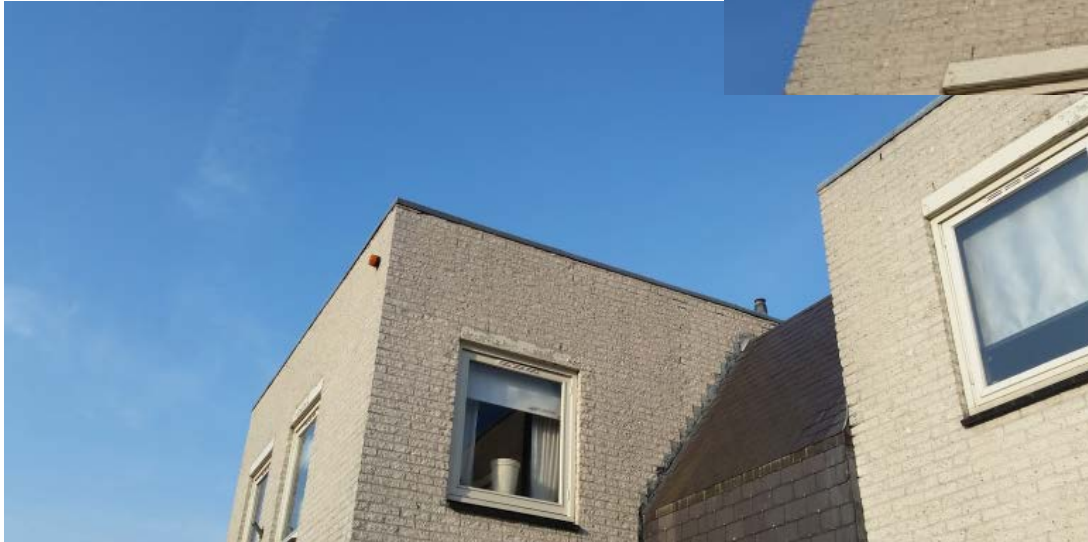
Open stootvoegen in gebouw 1
