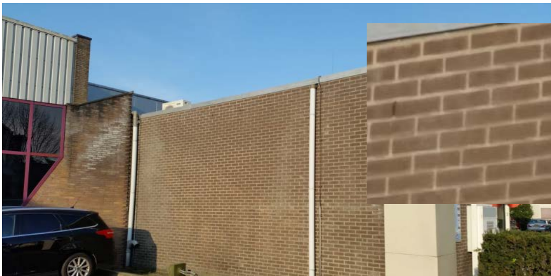
Open stootvoegen in gebouw 4
