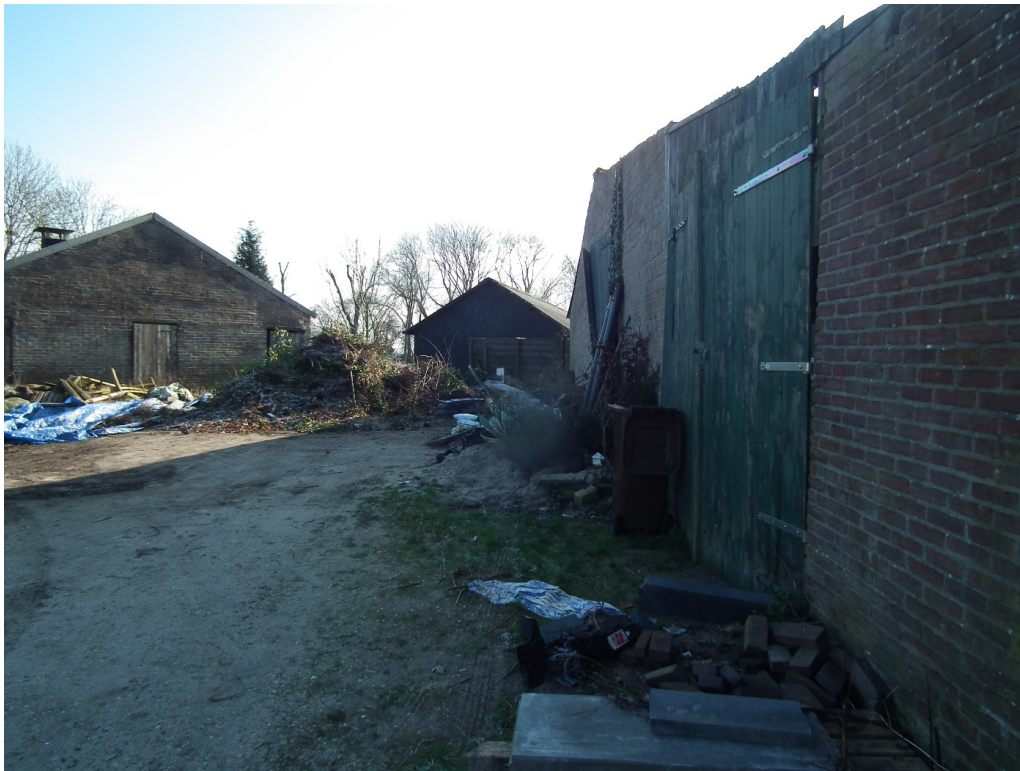
Figuur 3 De bestaande opstallen verkeren in een matige tot zeer slechte staat van onderhoud. Het betreft een vijftal gebouwen.
