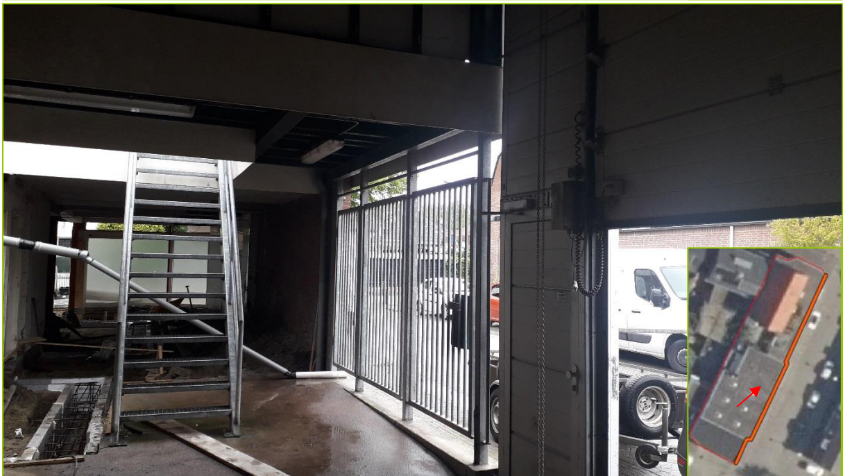
Op bovenstaande foto's is te zien dat de opening bij de roldeur geen enkele dekking biedt en geheel ongeschikt is als vleermuisverblijf.
