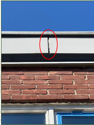
Fig. 2.17 Kieren betimmering (bron: FF Solutions)
