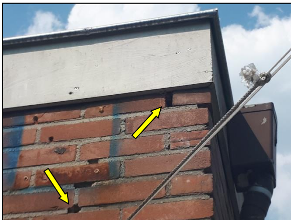
Figuur 1. De gaten in de muur kunnen gebruikt worden door gebouwbewonende vleermuizen.
