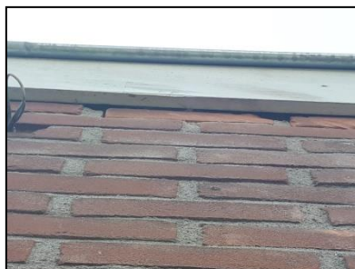
Figuur 10. Loszittende en/of missende gevelstenen.
