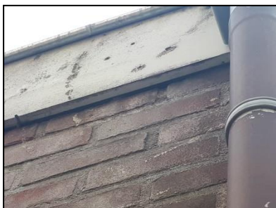
Figuur 9. Ruimte tussen betimmering en gevel.
