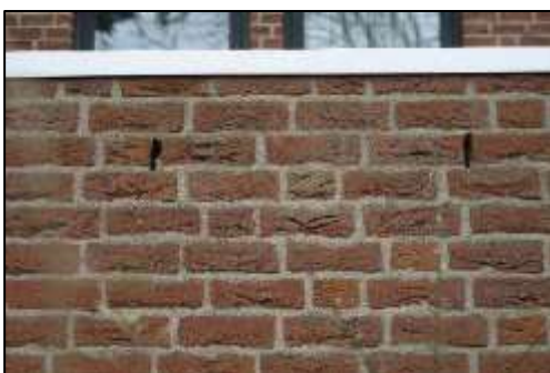
Foto 11. Open stootvoegen bij gebouw aan de Spanjaardsgoed 14
