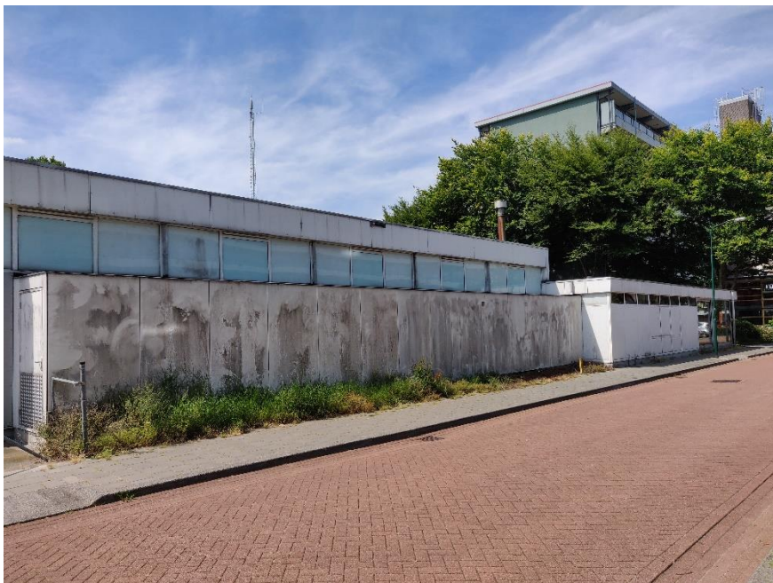
4 Gevelplaten aan achterzijde gebouw. Donkere plek in boeiboord is dakdoorvoer en niet geschikt als toegang tot het gebouw.
