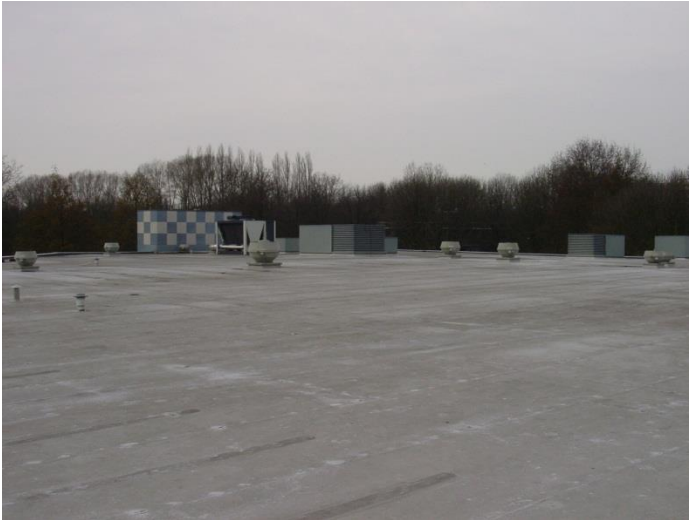
foto 3: technische installaties op het dak
