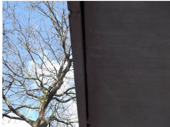
Foto 8: Close-up van de openingen tussen de betonnen rand en het overige beton van de oprit naar de hoofdingang: deze zijn > 1 cm, dus geschikt voor vleermuizen.
