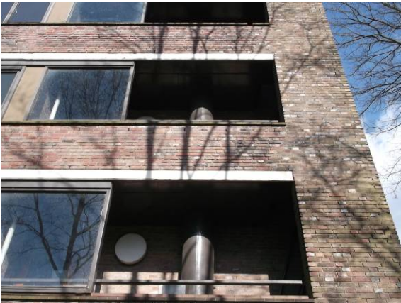
Foto 3: Open stootvoegen boven en onder de vensters van bouwdeel F en G, waardoor de spouwmuur van het gehele bouwdeel toegankelijk wordt voor bijvoorbeeld kleine dwergvleermuizen.
