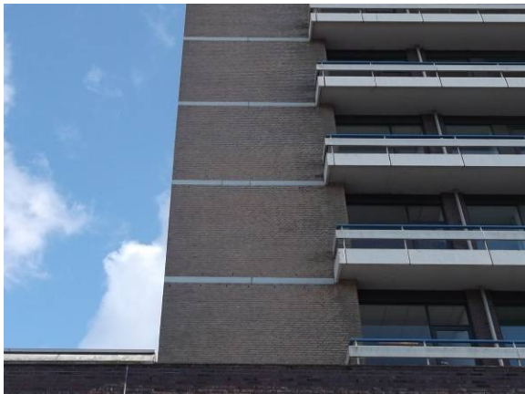
Foto 9: Ook heeft de ziekenhuisflat open stootvoegen van meer dan 1 cm, dus is dit gebouwencomplex geschikt als vaste verblijfplaats voor vleermuizen.
