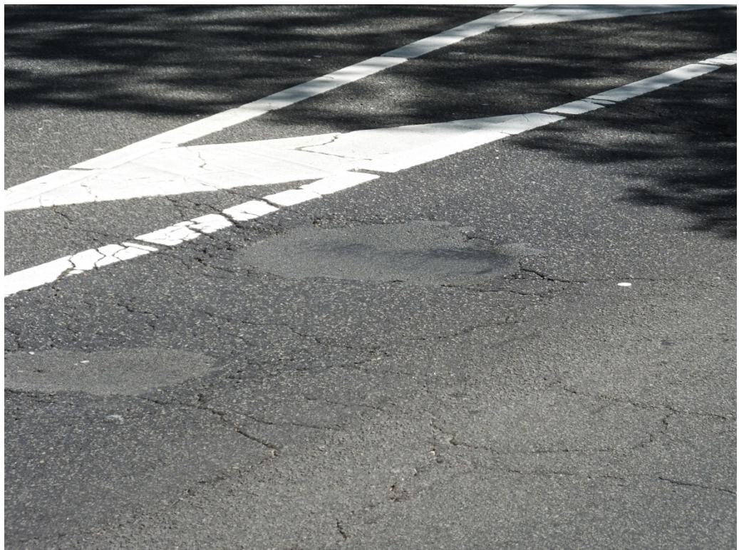
Figuur 6-1 Kuil in asfalt nabij bij Krikkelaan 2
