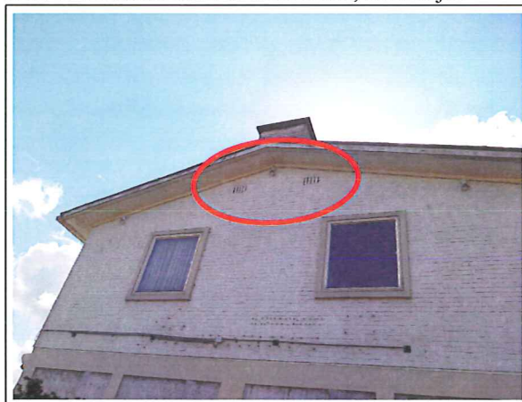
Foto 4: ventilatie sleuven in de muur, noordzijde
