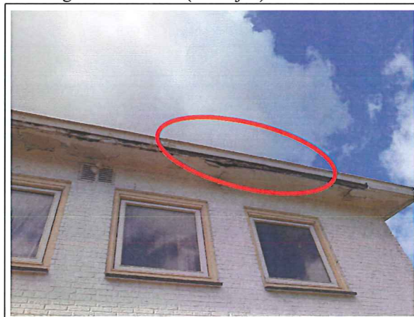
Foto 2: gaten in het dak (oostzijde)
