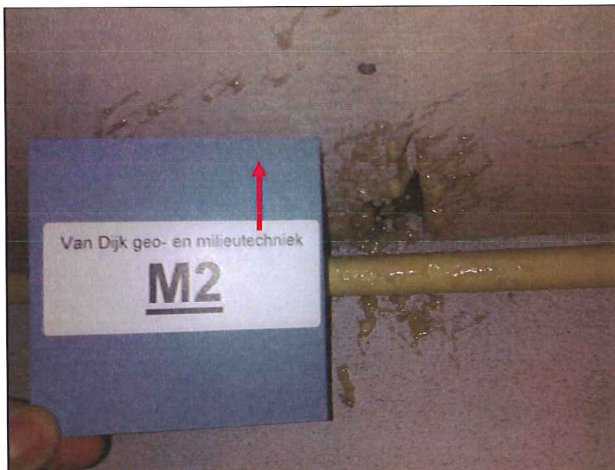
Foto 6: Item nr. 2: Asbesthoudende plafondbeplating
