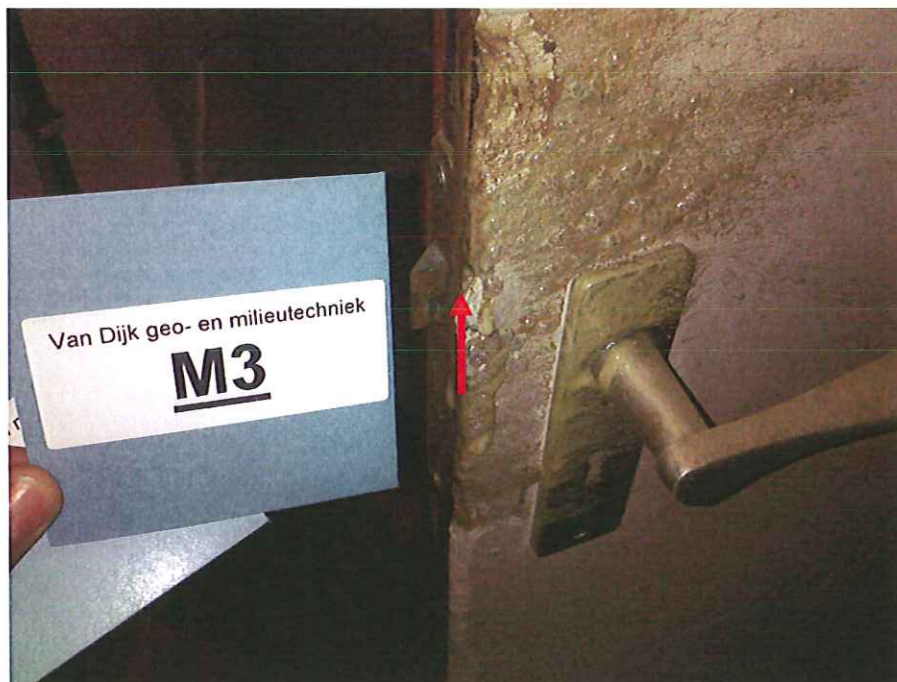
Foto 8: Item nr. 3: Asbesthoudende plaat op deur
