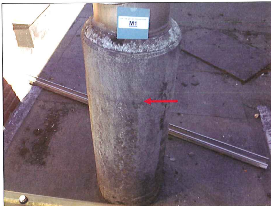
Foto 4: Item nr. 1: Asbesthoudende cementpijp
