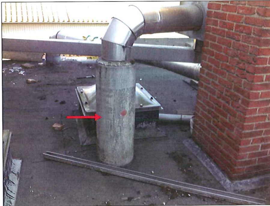
Foto 3: Item nr. 1: Asbesthoudende Cementpijp
