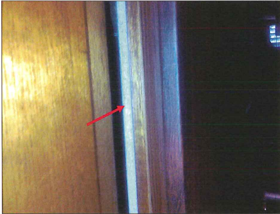
Foto 7: Item nr. 3: Asbesthoudende plaat op deur
