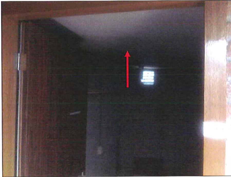
Foto 5: Item nr. 2: Asbesthoudende plafondbeplating
