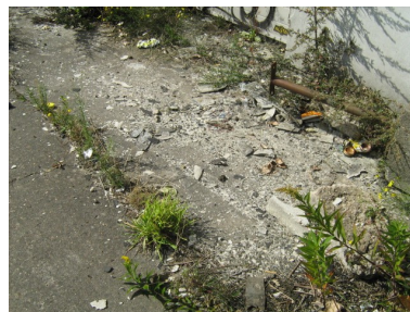
Foto 15: Stukjes asbestverdacht materiaal op betonverharding
