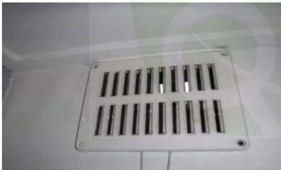
Ontluchting niet asbestverdacht
