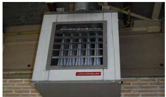
Heaters niet asbestverdacht
