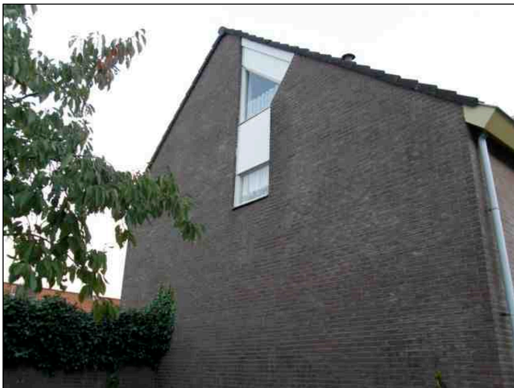
Open gevelzijde met mogelijkheden voor paarverblijven van gewone dwergvleermuis en nestplaatsen van huismus.
