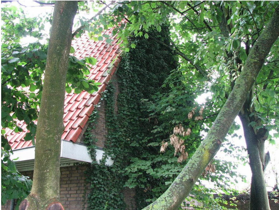
Foto 13: De dichte begroeiingen langs het trafogebouw vormen een geschikte broedplaats voor vogels.
