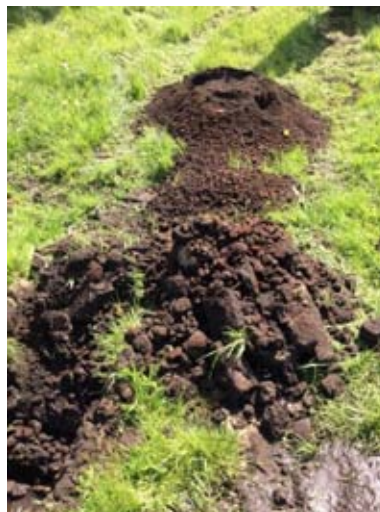
Sleuf 4 nader asbestonderzoek d.d. 3 mei 2018 Foto ontbreekt
