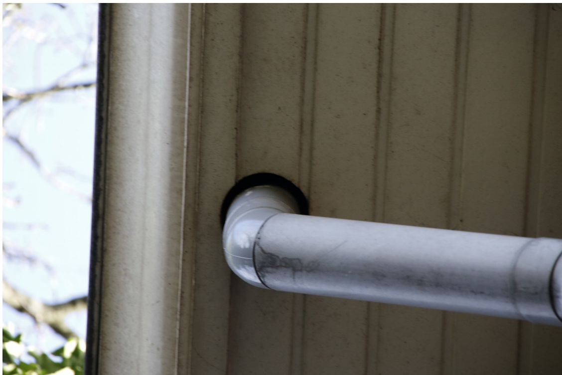
Op de plaats waar de regenpijp de onderzijde van de dak van het voormalige politiebureau binnen gaat bevinden zich kieren van 1-2 cm breed. Foto: K. de Vries | Ecoresult BV
