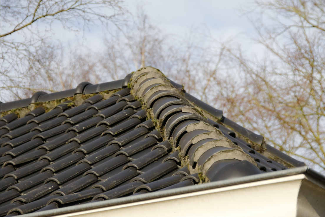
Aan de zuidzijde van het schilddak van het voormalige politiebureau liggen meerdere dakpannen scheef of los waardoor er ruimte onder de dakpannen is ontstaan. Deze ruimtes kunnen huismus en gierzwaluw als nestplaats gebruikt worden. Foto: K. de Vries | Ecoresult BV
