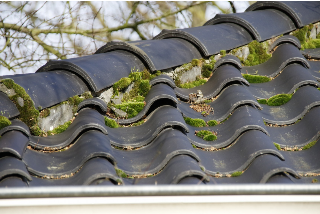
Ook op het schilddak van de garage liggen meerdere dakpannen los en of scheef, waardoor ruimtes zijn ontstaan onder de dakpannen. Deze ruimtes kunnen door huismus als nestplaats worden gebruikt. Foto: K. de Vries | Ecoresult BV
