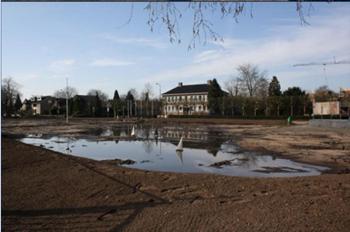
Figuur 21: Het gebied aan de Kampweg en Banningstraat ten tijde van de uitvoering van de bodemsanering in 2009.
