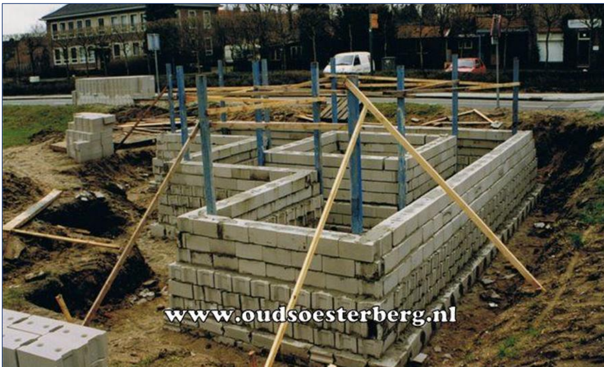
Figuur 19: Het monument op de hoek van de Kampweg-Banningstraat in aanbouw in 1998.
