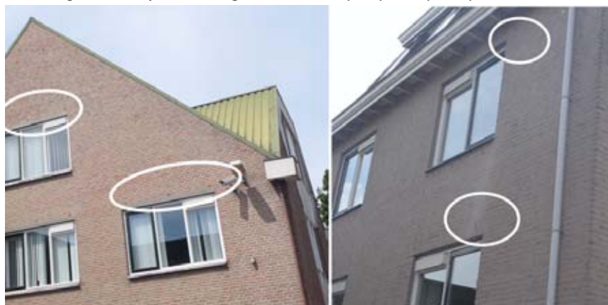
Afbeelding 10 en 11: Open stootvoegen Kerkstraat 85 (links) en 87 (rechts)
