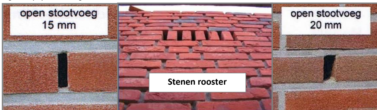
Figuur 6 | Open stootvoegen en een stenen rooster.
