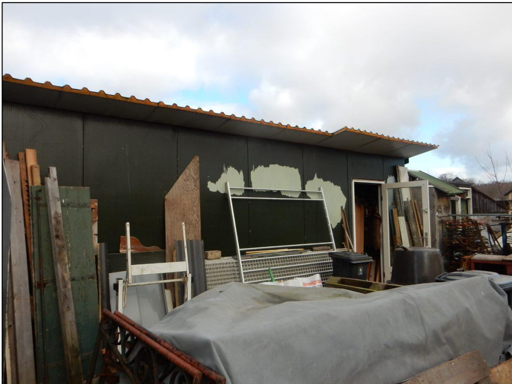
Figuur 2 Schuur 1. Dit gebouw zal gesaneerd worden.
