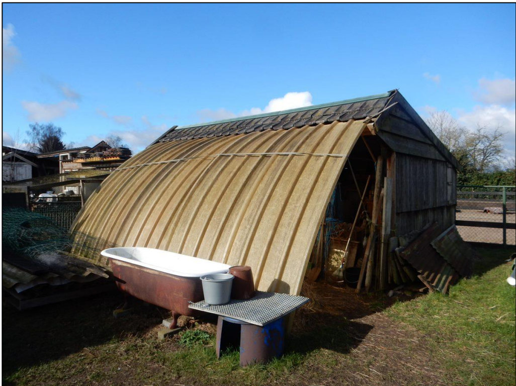
Figuur 6 Schuur 4. Dit gebouw zal gesaneerd worden.
