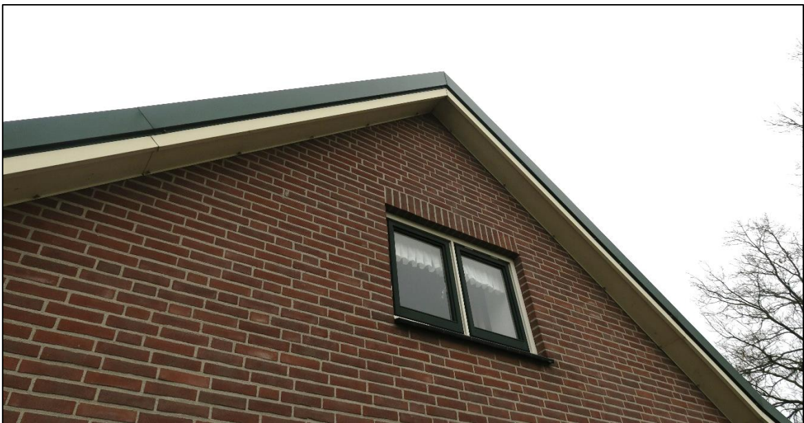
Figuur 3.2 De dakpannen ter hoogte van de kopgevels zijn afgeschermd middels een metalen ombouw welke strak aansluit op de muur.
