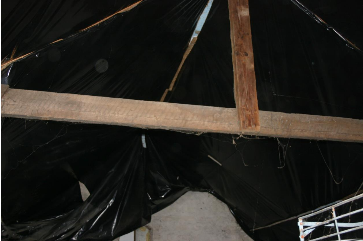
Figuur 7. Het plastic onder het dak van de aanbouw bij huisnr. 147
