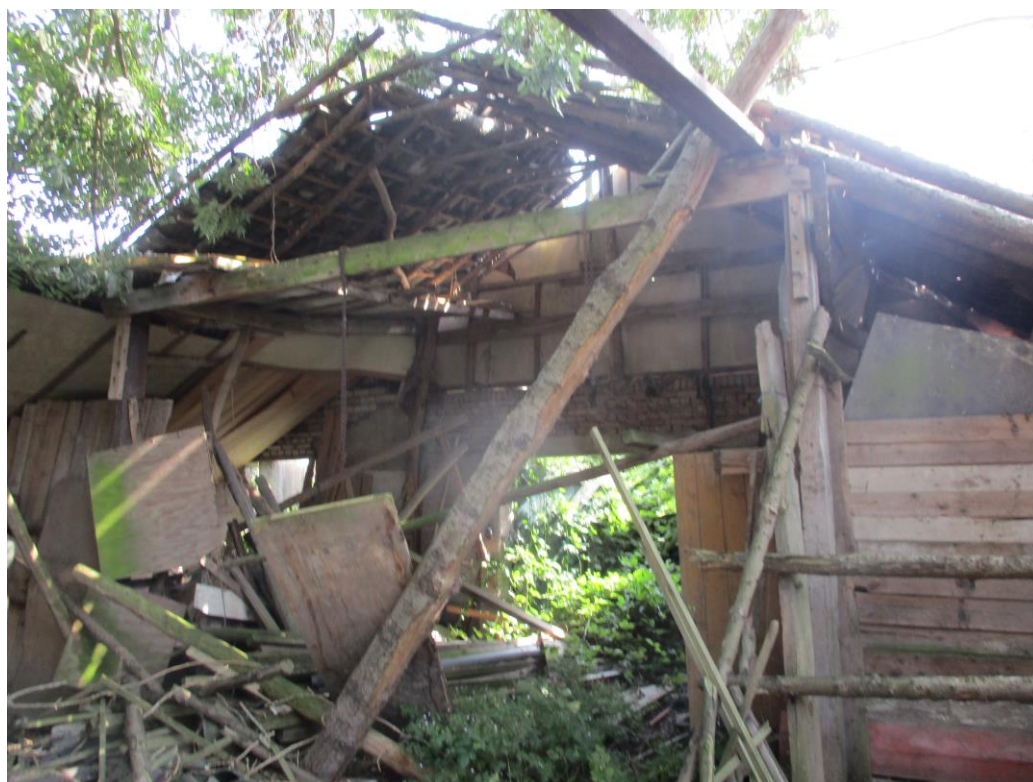
Figuur 2 Binnenzijde van één van de vervallen schuren. Hier is duidelijk te zien dat er geen beschutte ruimtes zijn waar vleermuizen een geschikte verblijfplaats kunnen vinden.
