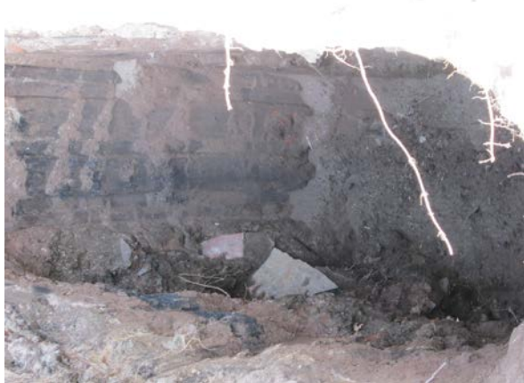
Foto 13: Asbesthoudend plaatmateriaal in de wand van sleuf S04
