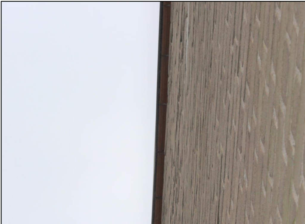
Figuur 4 Onder de metalen daklijsten van het gezondheidscentrum is een afdekmateriaal op de spouwmuur gelegen waardoor vleermuizen niet via de daklijst de spouwmuur kunnen bereiken. Vleermuizen kunnen echter wel via de open stootvoegen in de spouw terechtkomen.
