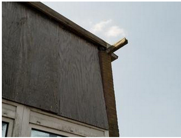
Afbeelding 8: Rechts naast de garagedeur bij de noordwestgevel zit een groot gat naast een houten paneel.
