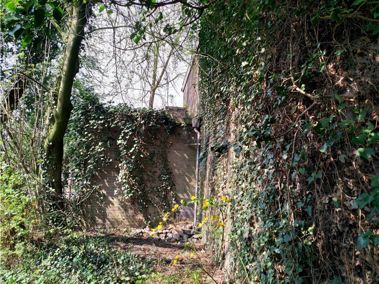
Achtergevel zuidelijke loods Franseweg 95 welke is overwoekerd met klimop. Foto: M. de Vries / Ecoresult B.V.
