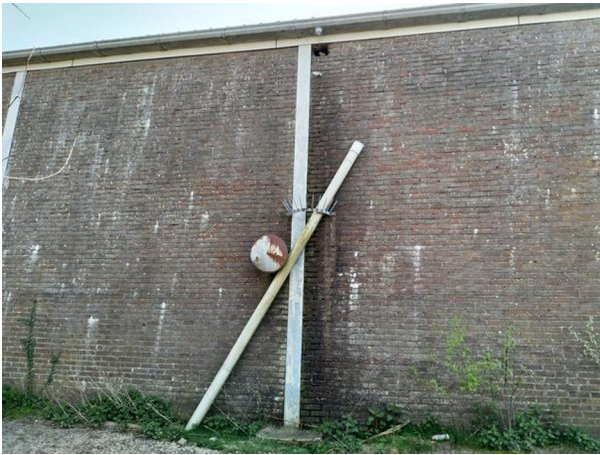
Afbeelding 7: Op enkele plaatsen aan de westgevel zijn regenpijpen los gekomen waar gaten zijn ontstaan in de gevel.
