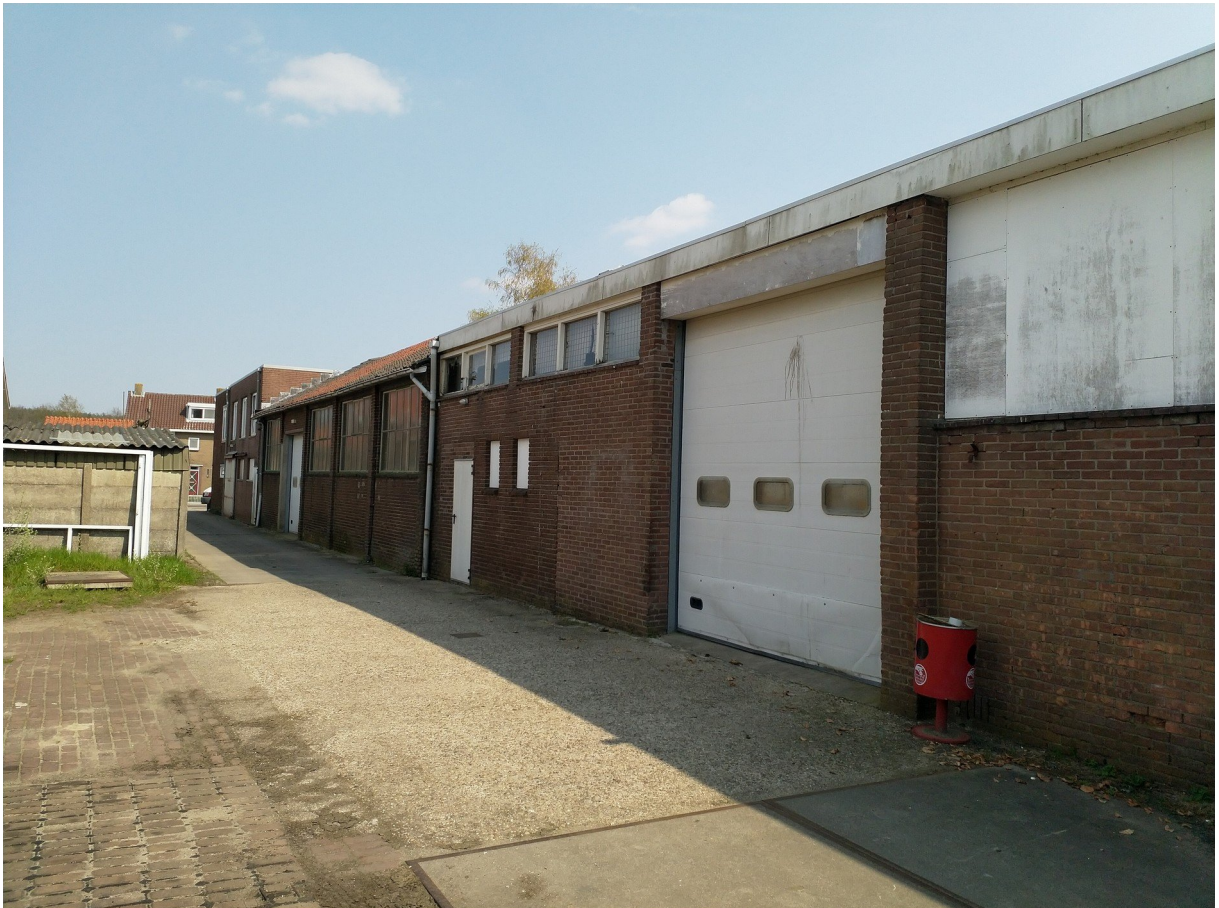
Zijgevel noordelijke loods Franseweg 95 met roldeur. Foto: M. de Vries | Ecoresult B.V.
