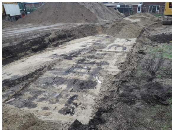
Foto 12: Aanwezige verontreiniging onder klinkerpad d.d. 6 april 2022
