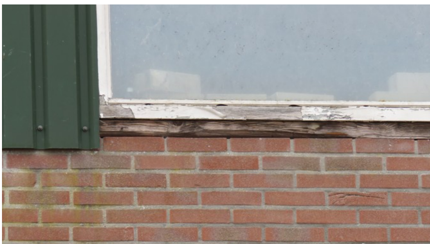
Afbeelding 9: Een kier onder het kozijn bij een bakstenen muurdeel van één van de opstallen, mogelijk geschikt als vleermuisverblijfplaats.
