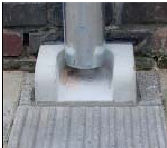
Figuur 11: regenpijp eindigend boven de grond
