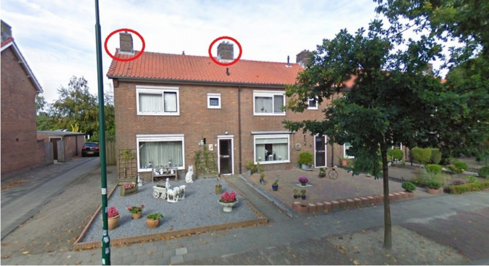
Kraamlocatie C, Taets van Amerongenweg 51 & 53, gewone dwergvleermuizen zijn zwermend en uitvliegend waargenomen bij de open stootvoegen in de linker schoorsteen. Vanuit de rechter schoorsteen zijn jonge roepende dieren gehoord.
