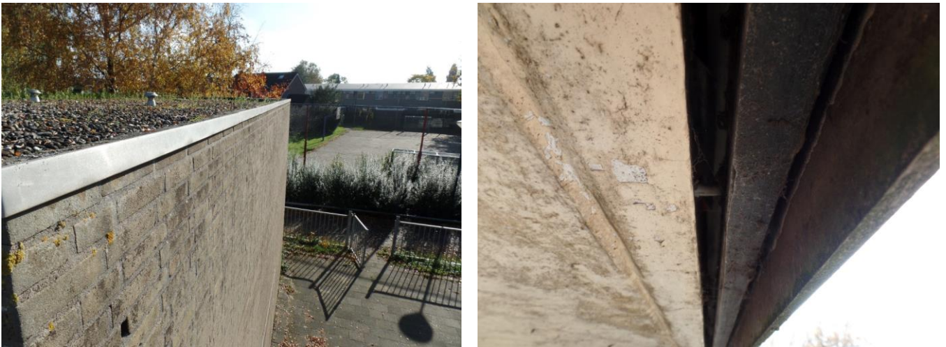
Figuur 10 – links: ventilatieopening in westgevel; rechts: kier achter daklijst aan oostzijde.
