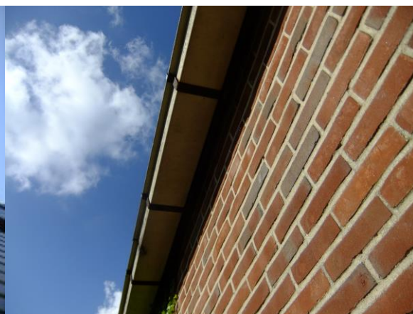
Figuur 5-2 Dakgoot strak tegen muur
