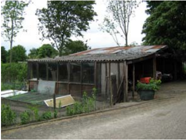
Foto 4: Bijgebouwtje met asbestverdachte golfplaten.
