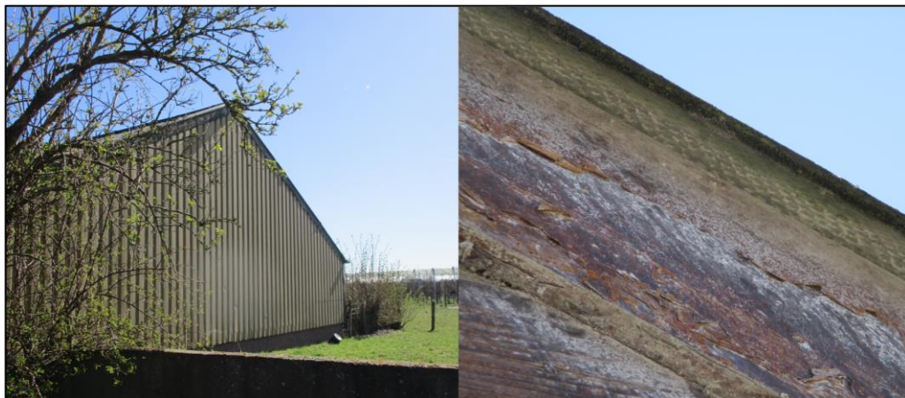
Figuur 4 De te saneren loods is opgetrokken uit damwandplanten (links) en potdeksels (rechts) die direct op elkaar aan sluiten en hierdoor ontoegankelijk zijn voor vleermuizen.
