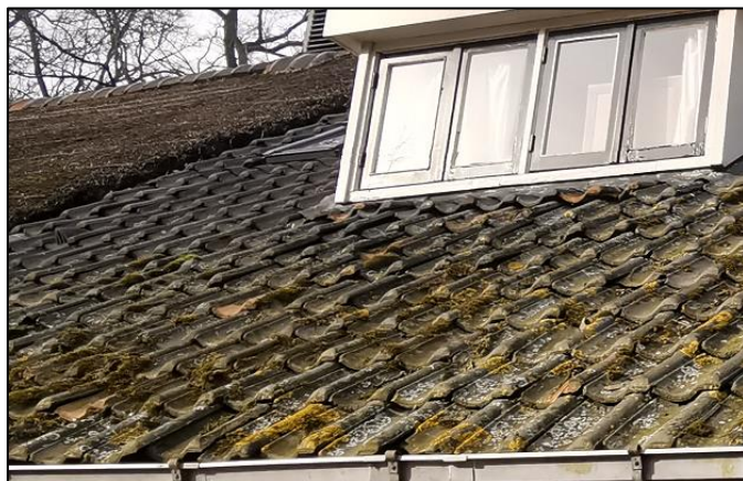
Figuur 6.1: Impressie van het pannendak met loszittende dakpannen.
