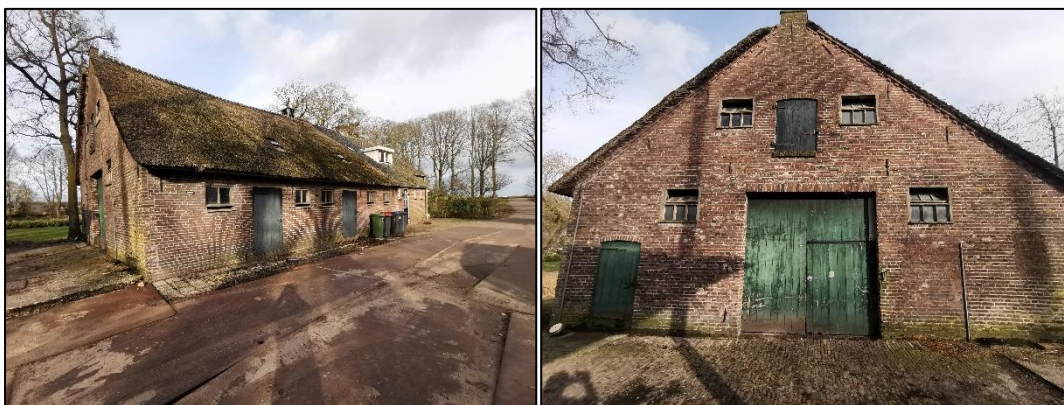
Figuur 2.4: Impressie van de stal achter de woning met een rieten dak waar wegens gebrek aan onderhoud openingen in zijn ontstaan.
