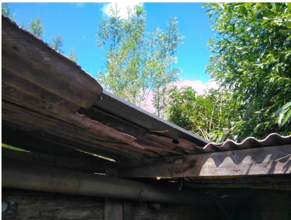
Foto 6: overzicht asbestverdachte daken in slechte toestand
