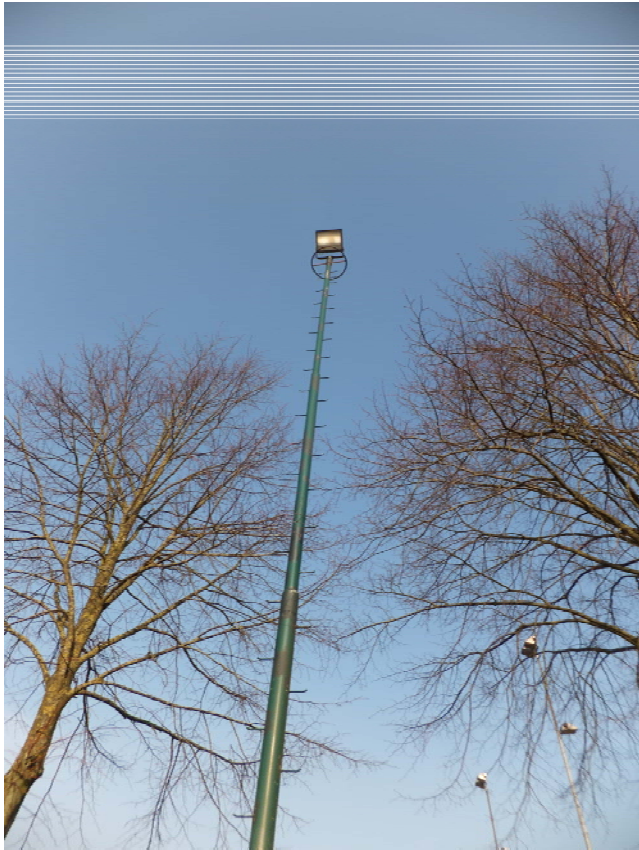
Foto 10 Plaats lampen langs trainingsveld voetbal hoogte 11,5 m
