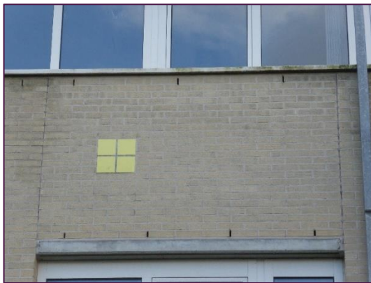
Figuur 4.5. Open stootvoegen in de spouwmuur.
