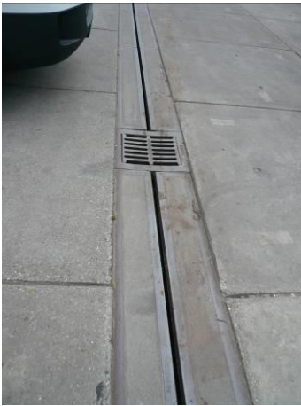
Bestaande hemelwaterafvoer buitenverharding
