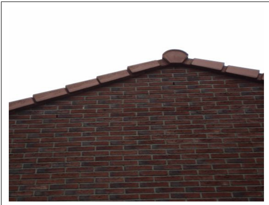
Foto 5. Open stootvoegen aan het hotel, ter plaatse van de voorgenomen aanbouw.
