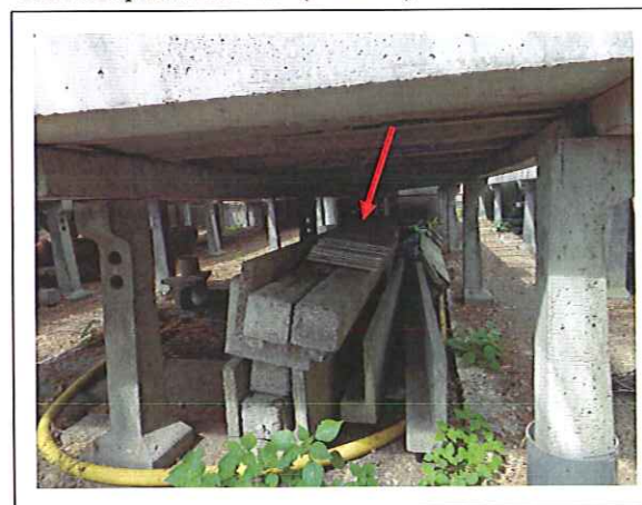
Foto 16: plaatmateriaal (item 6.4) in kas
