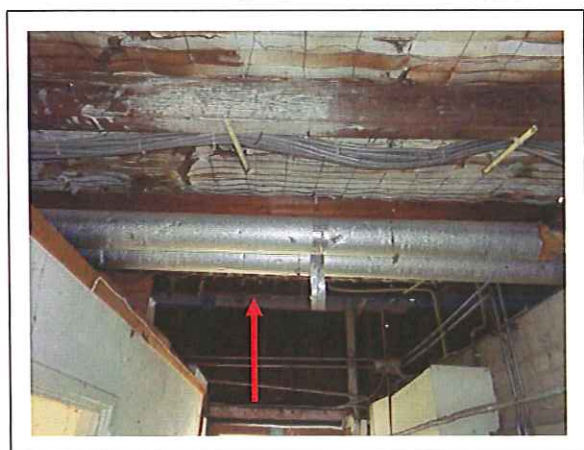
Foto 5: isolatiemateriaal aan binnenzijde dak kantine met daarboven de golfplaten dakbedekking (item 1)
