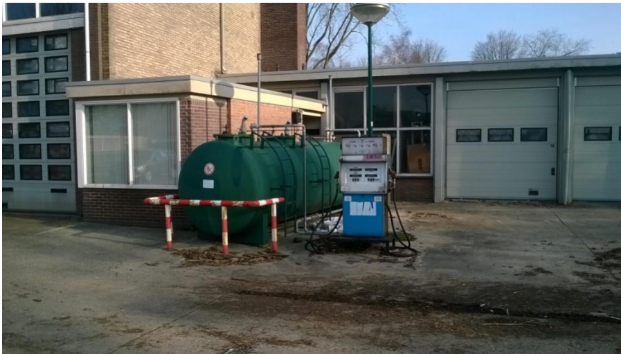
Foto 2.1: Bovengrondse tank ter plaatse van locatie 5 (dieselafgiftepunt) (bron: Grontmij)
