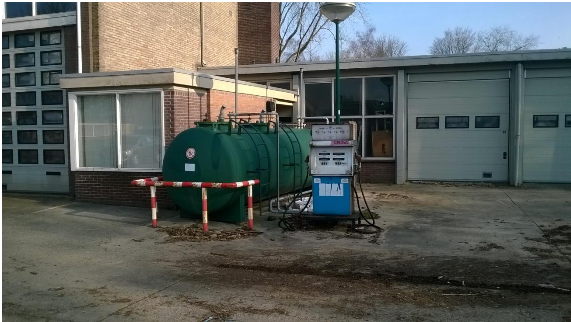
Foto 5.1: Bovengrondse dieseltank aan de noordzijde op het terrein
